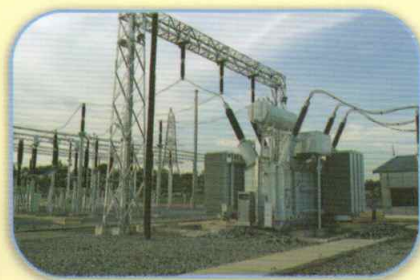
运行于乌干达变压器 OSFPSZ-250000kVA/220kV
