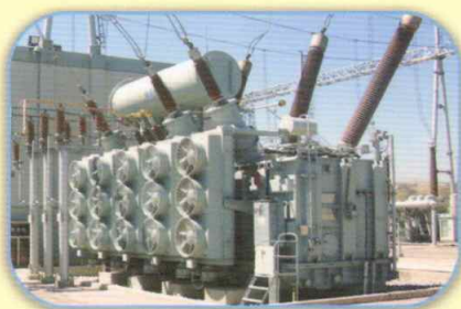
甘肃酒泉榆中钢铁 OSFPSZ-360000kVA/330kV
